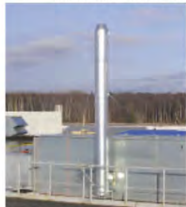
Модульная котельная в пос. Роцино труба \varnothing 250/350
