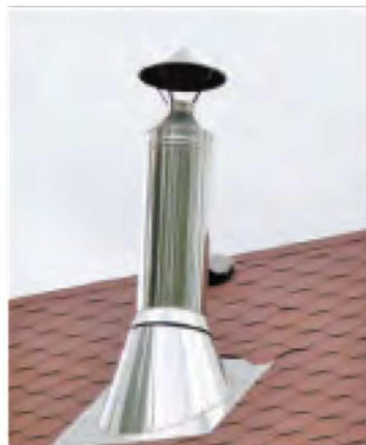
Частный дом в пос Васкелово трубы \varnothing 150/250
